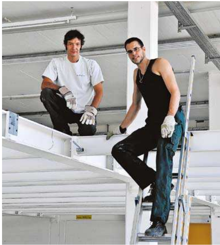
Alejandro Miquel (l.) und Florian Roth müssen nur noch diese Stahlträger demontieren, dann ist die Lagerhalle für den Einbau der Kletterwände bereit. (Bilder: Kevin Knecht)
